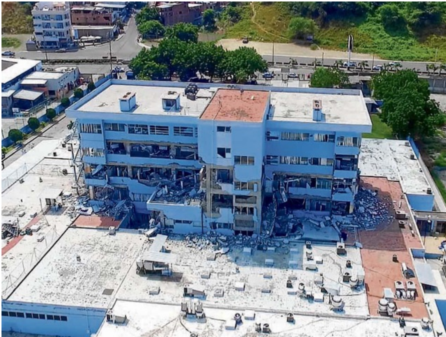
Ein total zerstörtes Krankenhaus in Manta, das komplett abgerissen wurde. Heute liegt hier ein offenes, aufgeräumtes Feld, auf dem das Gras schon angefangen hat zu wachsen.
